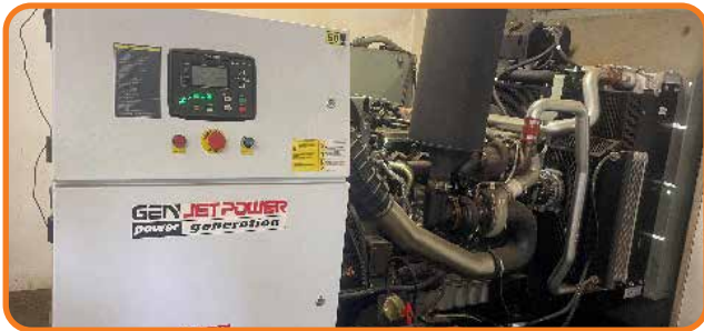
OVR - New Generator.
